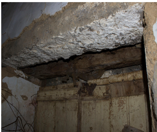
fig.23 | Falha de reboco
