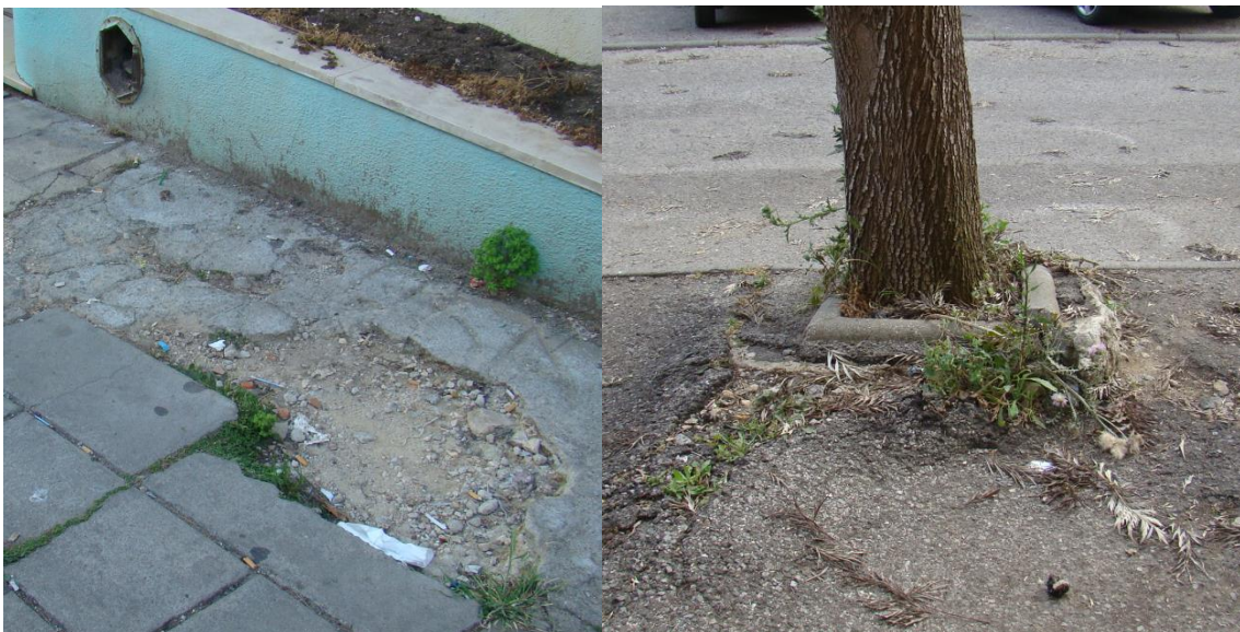
Fotografia 19: Degradação do pavimento.
