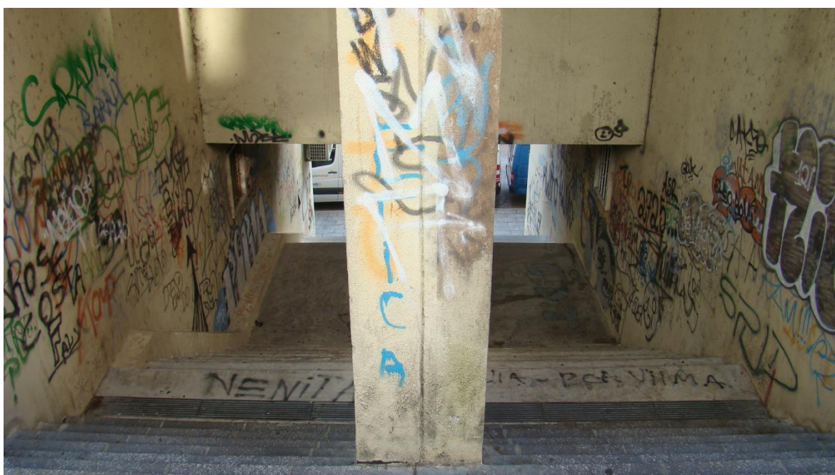
Fotografia 28: Escadaria entre prédios alvo de vandalismo.
