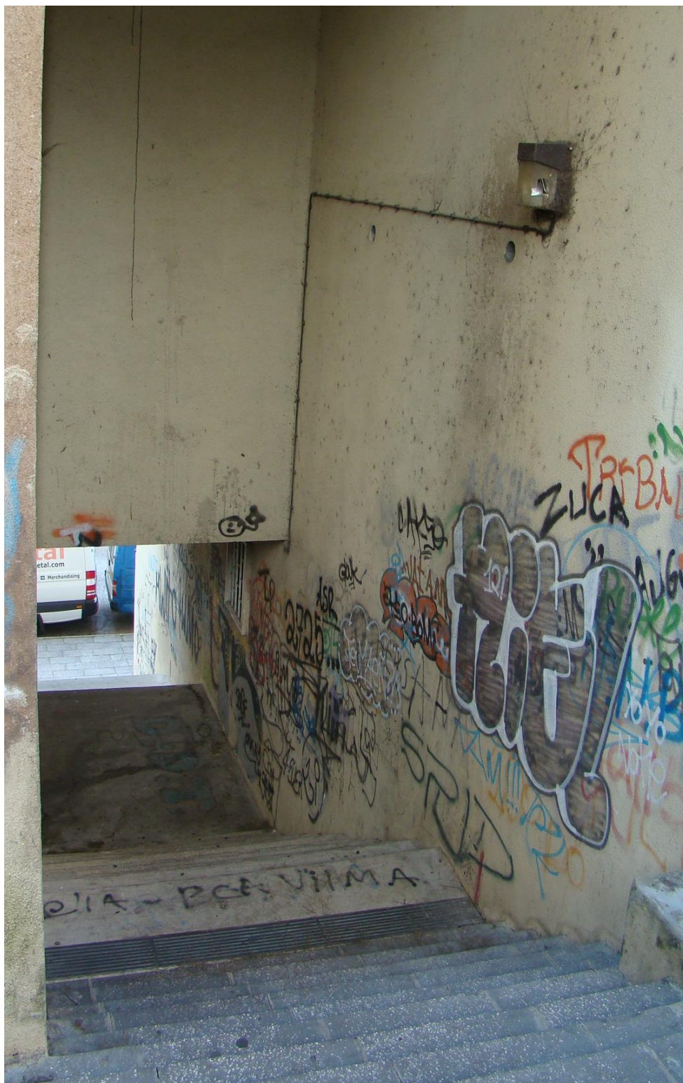
Fotografia 33: Escadaria entre prédios com dispositivo de iluminação vandalizado.
