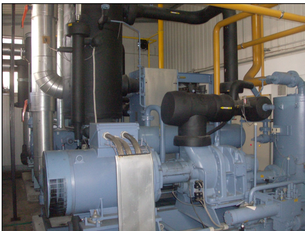
Figura 8.15 - Compressores de frio Grasso
