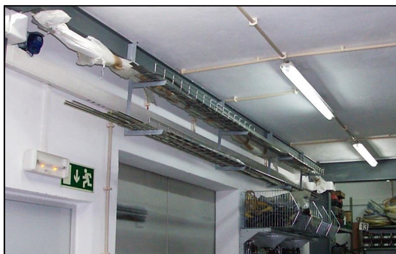
Figura 7.10 - Estrutura aérea de armazenagem de materiais grandes dimensões
