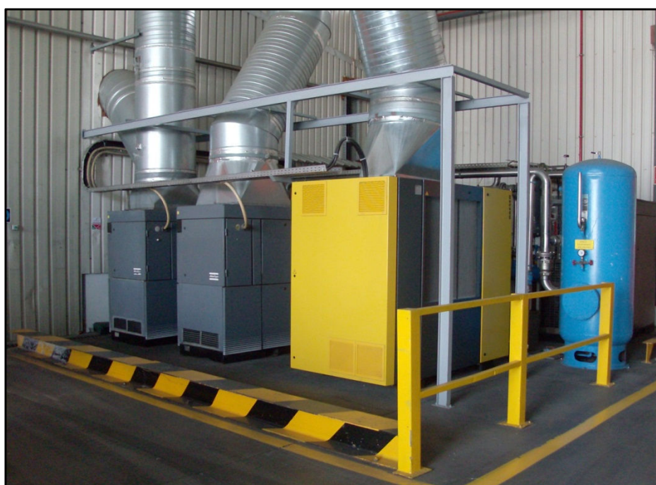
Figura 8.7 - Central de ar comprimido
