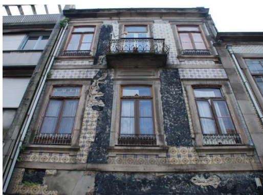
Figura 82 Perdas de azulejos de grande expressão 114
