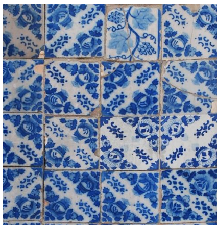
Figura 88 Azulejos mal colocados 120
