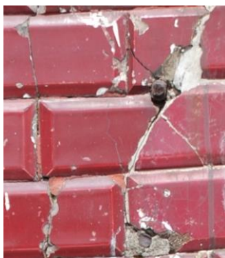
Figura 95 Anomalia derivada de tensões excessivas 126
