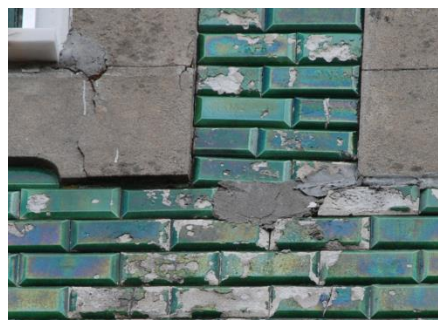
Figura 87 Fissuras resultantes de problemas estruturais
