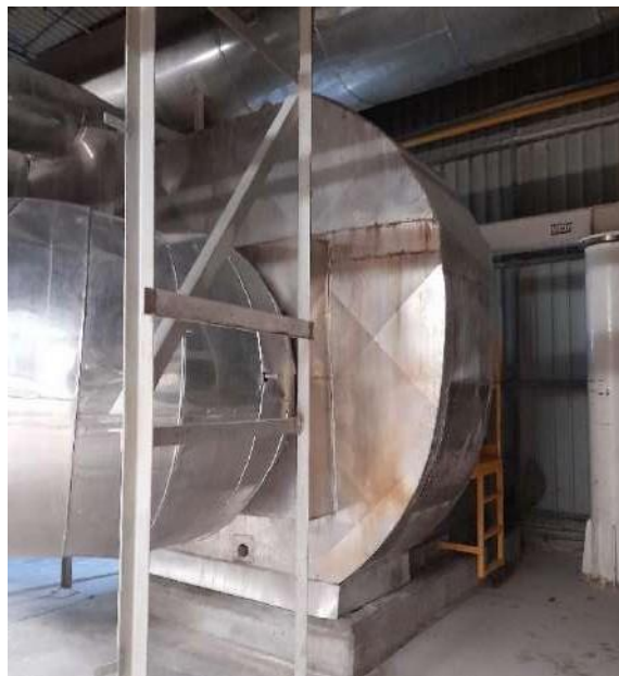
Figura 66 - Ventilador de recirculação do lado seco - VT652
