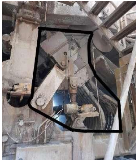
Figura 7 - Caixa de chegada HTB 2L da MP6
