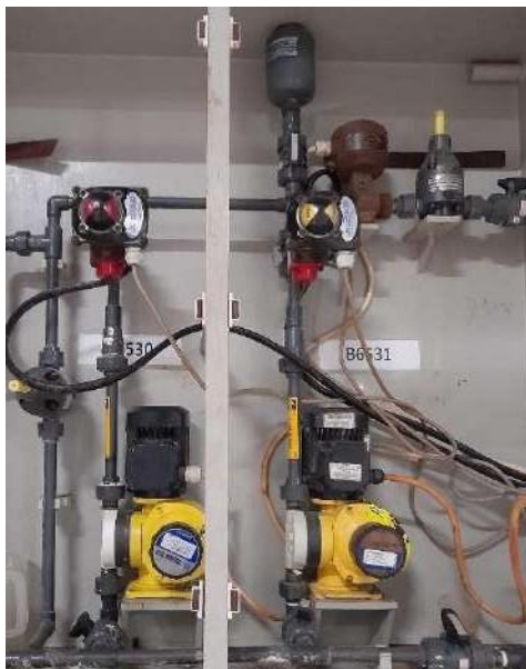
Figura 60 - Bombas doseadoras de Pax da MP6 - B6530 e B6531
