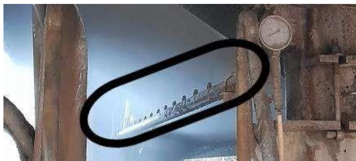
Figura 25 - Chuveiros ou "Regadeiras" de lubrificação do feltro da MP6
