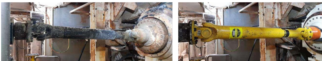
Figura 91 - MELHORIA-Substituição do cardan (MP5)
