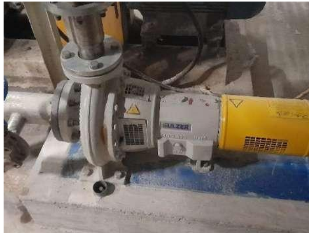
Figura 58 - Bomba do sistema extração de pó das raspadeiras - BB680
