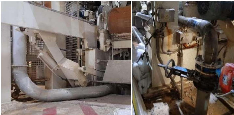
Figura 32 - Tubos coletores de poeira
