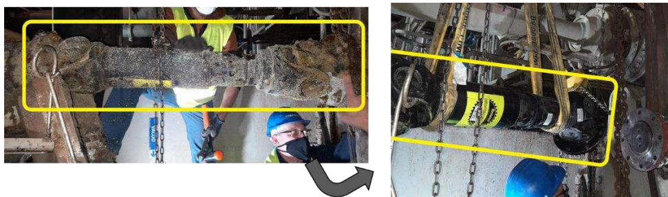
Figura 84 - MELHORIA-Substituição do cardan (MP6)
