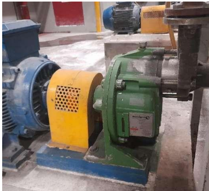
Figura 67 - Bomba nº1 dos chuveiros de água quente – BB623A
