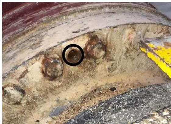
Figura 80 - MELHORIA-Tamponar os furos de fixação das trancas (MP6)
