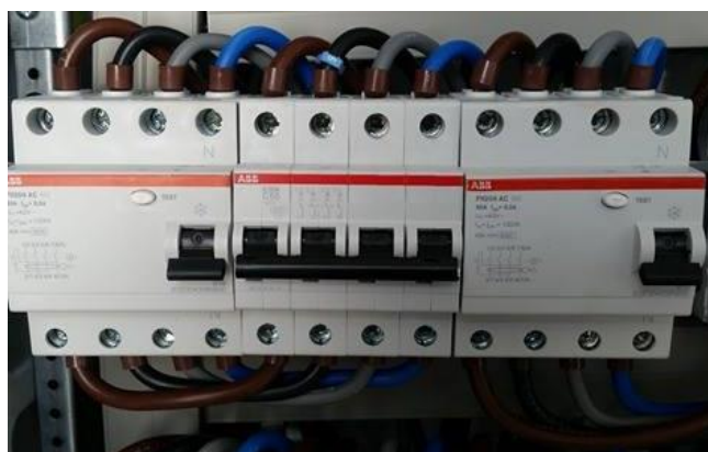
Figura H.8 – Dois interruptores diferenciais 4P 63 A 300 mA e um disjuntor 4P 50 A 6 kA curva C no meio.
