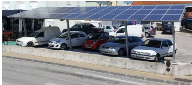
Figura B.19 – Estacionamento realizado através de módulos fotovoltaicos sobre uma estrutura própria, elaborado pela empresa.
