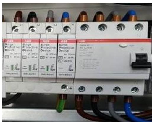
Figura H.7 – Descarregador de sobretensão AC trifásico I_n = 20 \text{ kA} I_{\text{máx}} = 40 \text{ kA} e interruptor diferencial 4P 63 A 300 mA.
