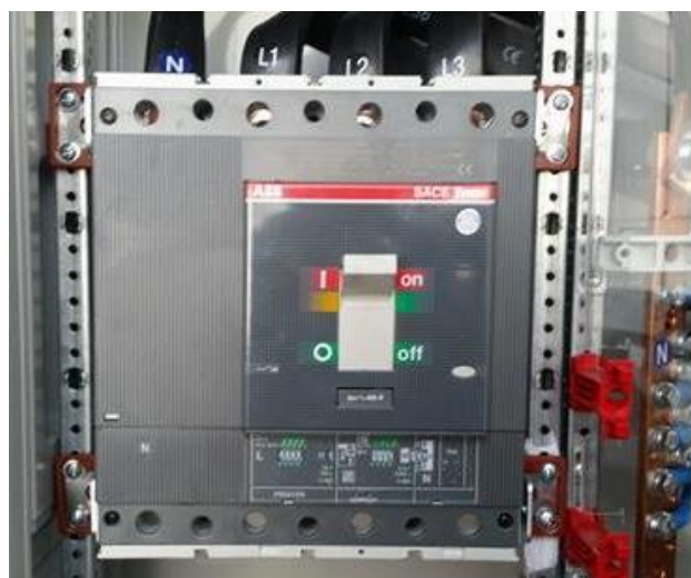
Figura H.6 – Disjuntor de corte 4P 4D(N50%) 400 A 50 kA.
