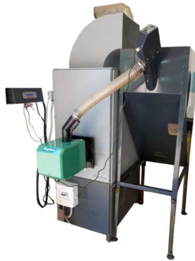
Figura 13 - Queimador a pellets instalado num permutador de calor ar/ar – Fonte [4].
