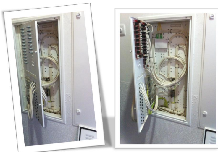
Figura 13 – Armário de Telecomunicações Interior instalado em obra.
