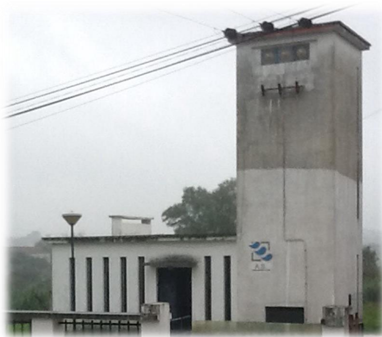
Figura 10 – Imagem elucidativa de um Posto de Transformação do tipo ‘Cabine Alta’.
