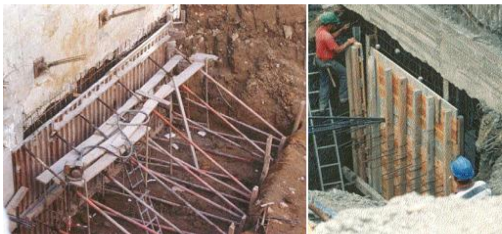
Figura 2.7 - Cofragem dos painéis com recurso a cofragem metálica (à esquerda) ou de madeira (à direita) (Brito, 2001)
