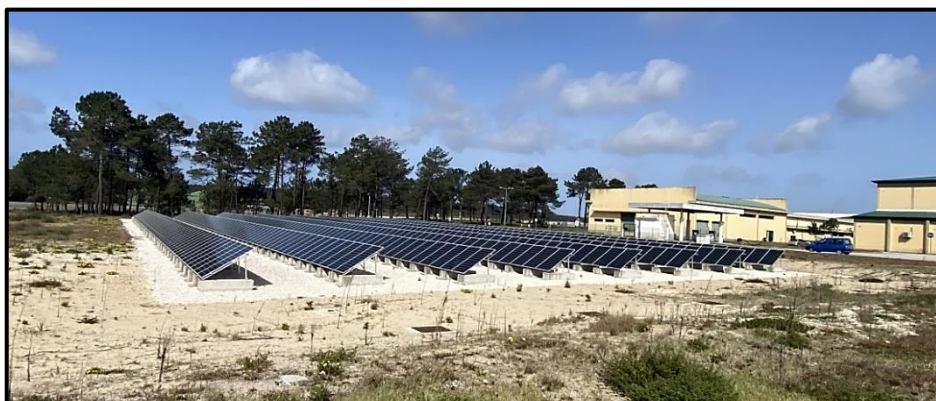
Figura 6 - Parque de painéis fotovoltaicos da Base Aérea n.º 5
