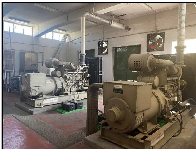
Figura 7 - Dois grupos eletrogéneos num posto de transformação da Base Aérea n.º 5
