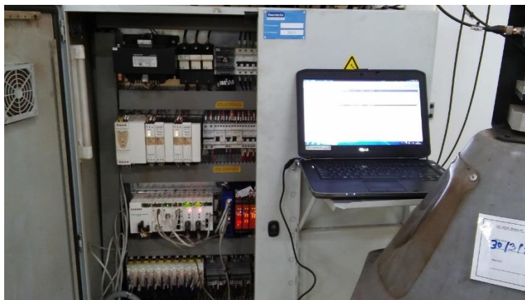
Figura 19 - Quadro elétrico com PC conectado para ensaio/testes.
