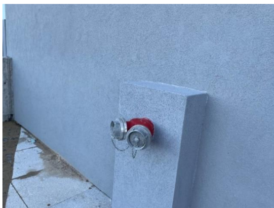
Figura 21 - Entrada de água, sistema de incêndio. Fonte: Autor.
