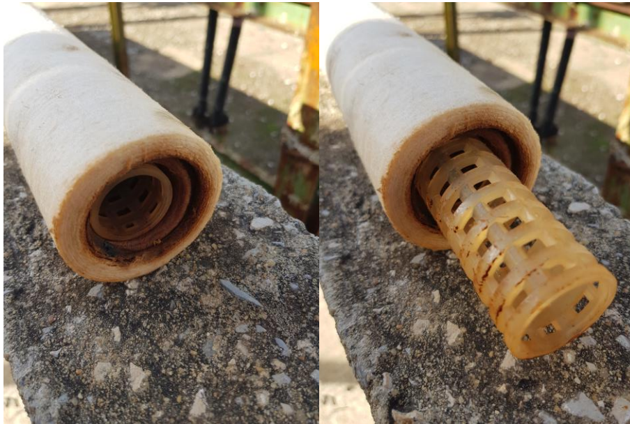
Figura 32: Filtros com defeito.
