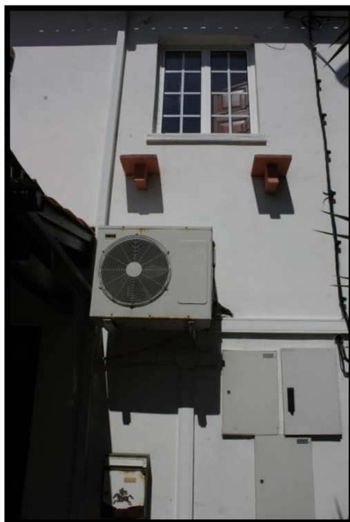
Figura IV.8 - Ar condicionado: unidade exterior.
