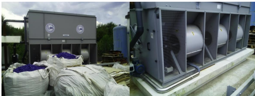
Figura 2.25 - Torre de refrigeração.
