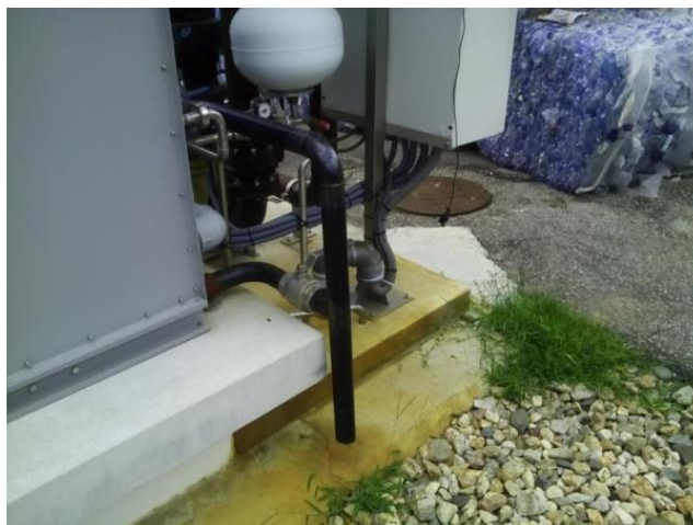
Figura 2.31 - Ponto de recolha da torre de refrigeração.
