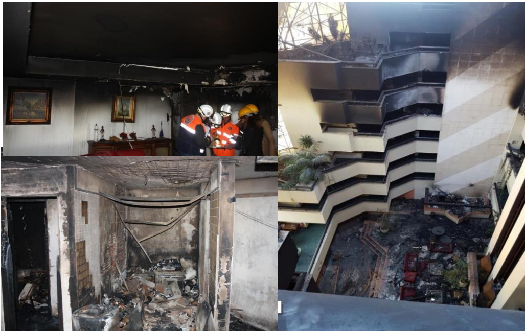
Figura 17: Danos causados pelo incêndio
