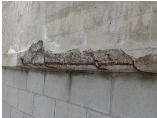
Figura 15: Fendilhação e destacamento do betão devido a corrosão das armaduras.
