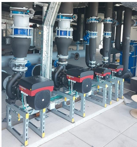
Figura 44 – Bombas de circulação
