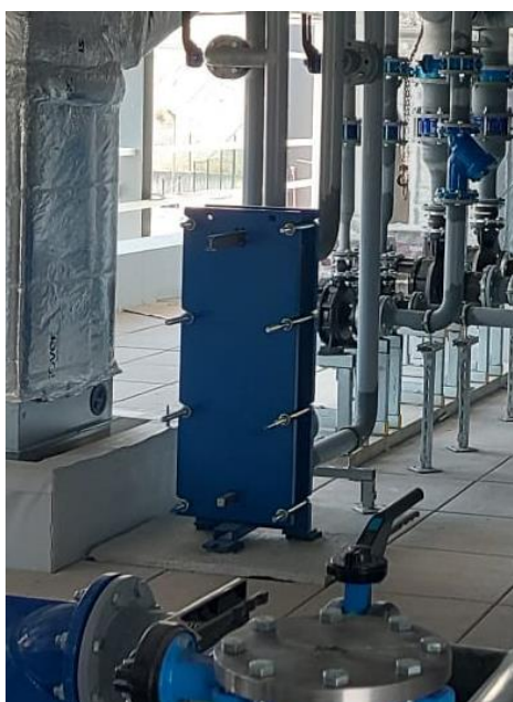
Figura 48 – Permutadores de calor
