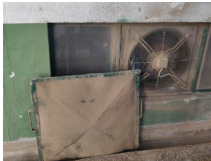
Figura 4.38 – Ventilador da sala das torrões antes de intervenção
