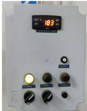
Figura 4.27 – Quadro de Controlo Bola de Torrar 2
