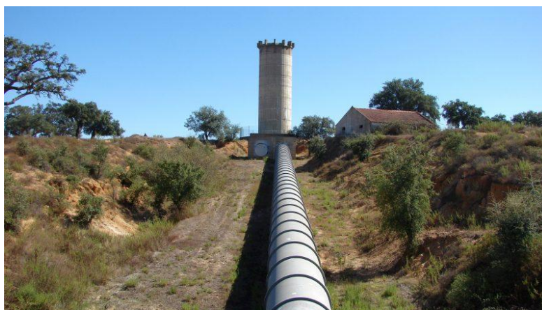
Figura 7 - Sistema de adução de Morgavel (Imagem retirada do site Campo d'Água)
