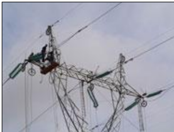
Figura 17 - Rede de Alta Tensão.
