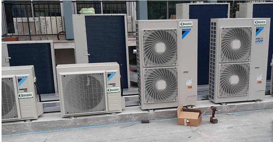
Figura 2.3 - Unidade exterior VRV e splits da obra do Sindicato dos Bancários de Centro.
