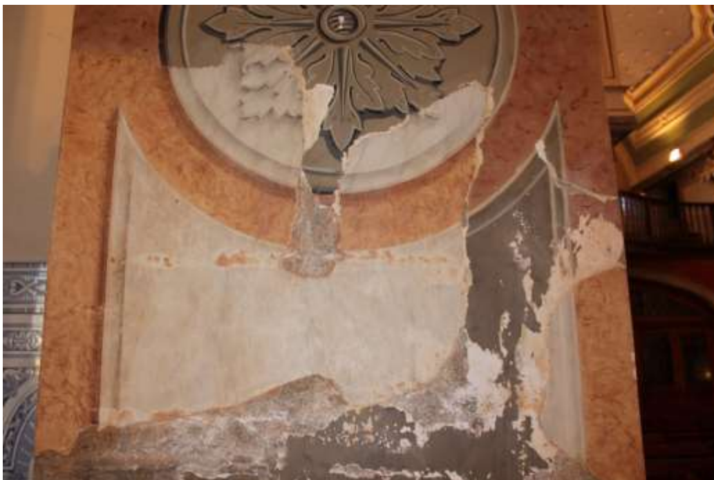
Figura 38 - Estado de Conservação Inicial do Arco da Capela Lateral do Lado da Epístola- C.F. – Autoria Própria.
