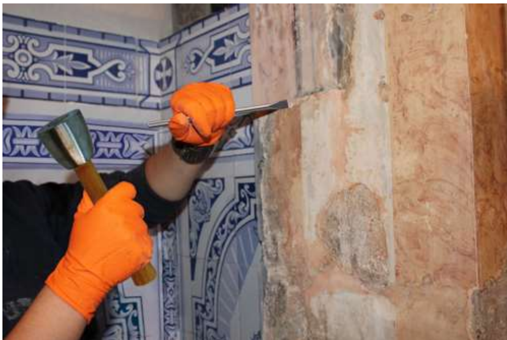
Figura 28 - Remoção do Cimento Portland com Maceta e Escopro sem Pastilha. C.F – Autoria Própria.
