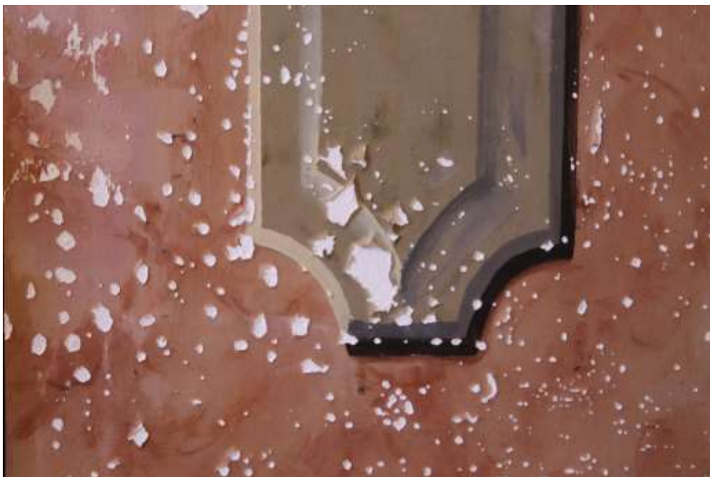
Figura 42 - Detalhe das Argamassas com Base em Gesso no Arco da Capela Lateral do Lado do Evangelho. - C.F. - Autoria Própria.
