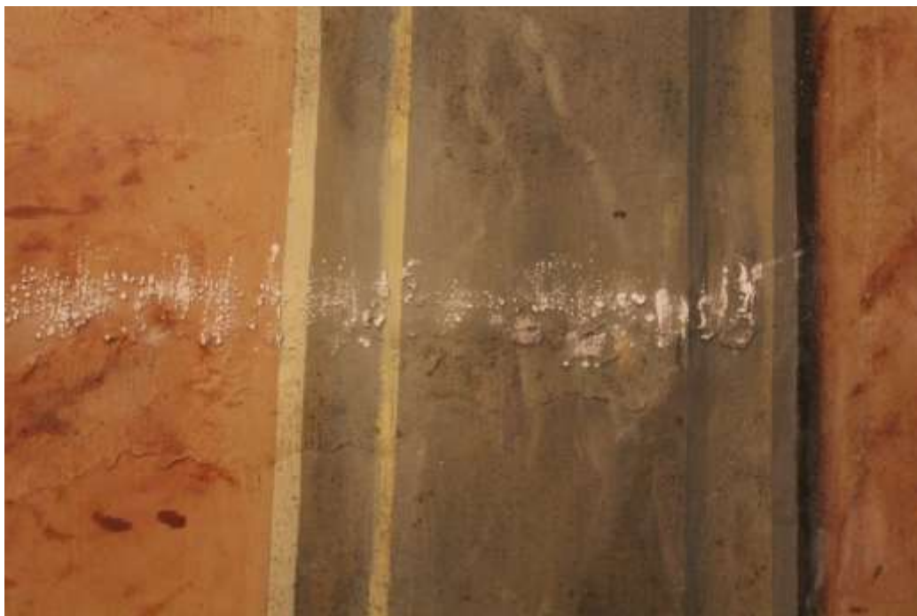
Figura 17 - Detalhe da Alteração e Degradação nas Argamassas com Base em Gesso Provocada por Eflorescências Salinas. - C.F – Autoria Própria.
