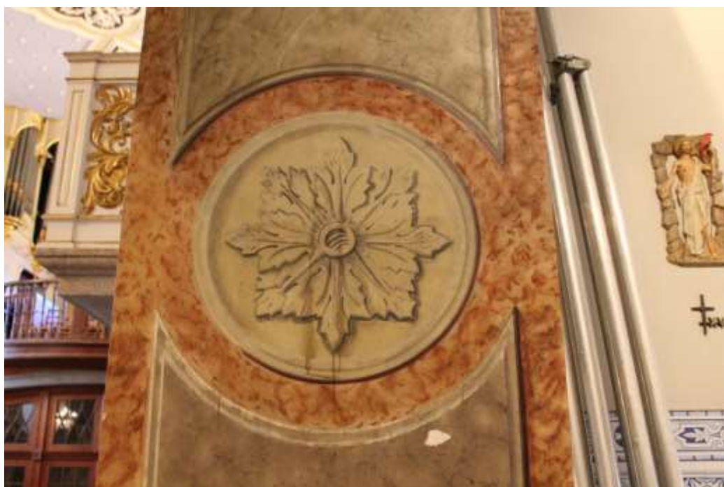
Figura 41 - Estado de Conservação Inicial Arco da Capela Lateral do Lado do Evangelho. - C.F. - Autoria Própria.
