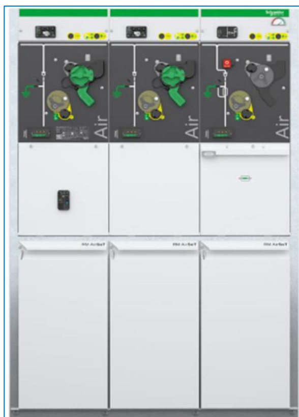
Figura 7 - Aparelhagem Modular do Tipo BRA 2I+Q [10]
