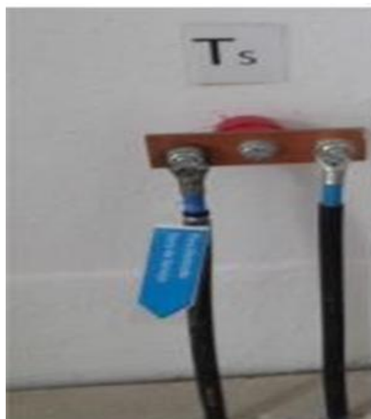
Figura 11 - Aterramento com Elétrodo [16]
