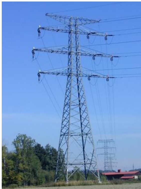
Figura 16 - Torre metálica trelaçada em ângulo [18]
