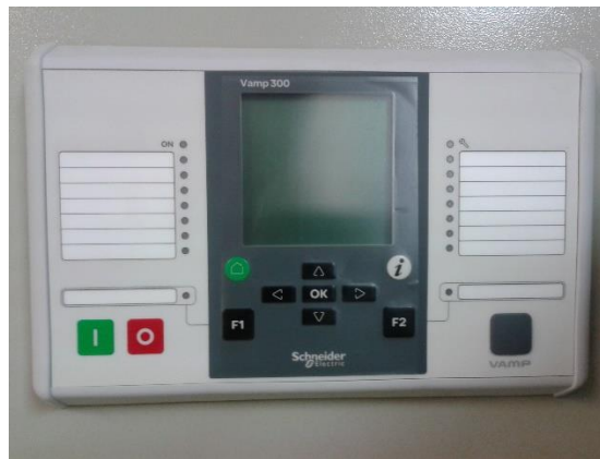
Figura 4.10 – Display do relé proteção VAMP 300
