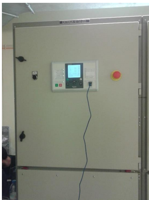
Figura 4.24 – VAMP 300F instalado na cela de entrada 67.53 221
