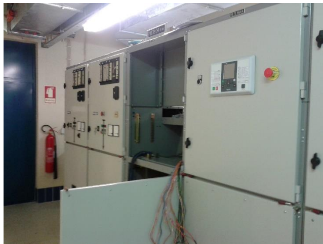
Figura 4.19 – Modernização da cela 91.31 665B
