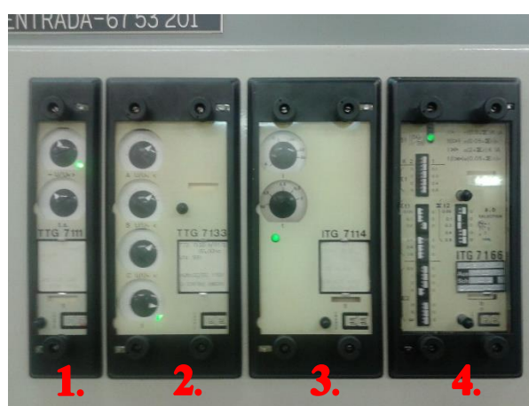
Figura 4.8 – Módulos de proteção do quadro de entrada
