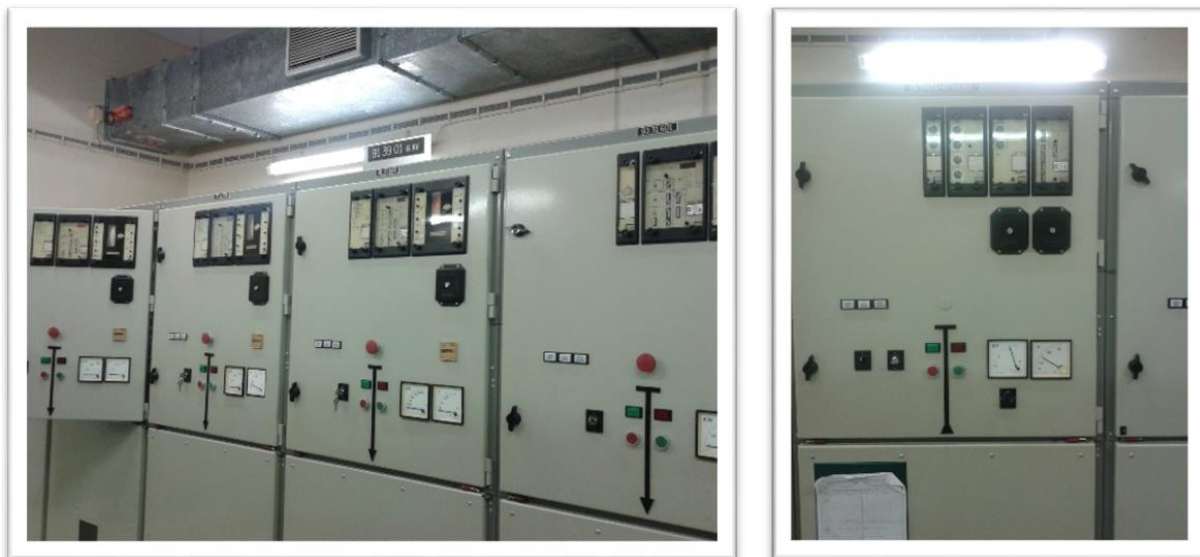
Figura 4.3 – Relés de proteção dos motores e entrada do MCC 91.39 01
