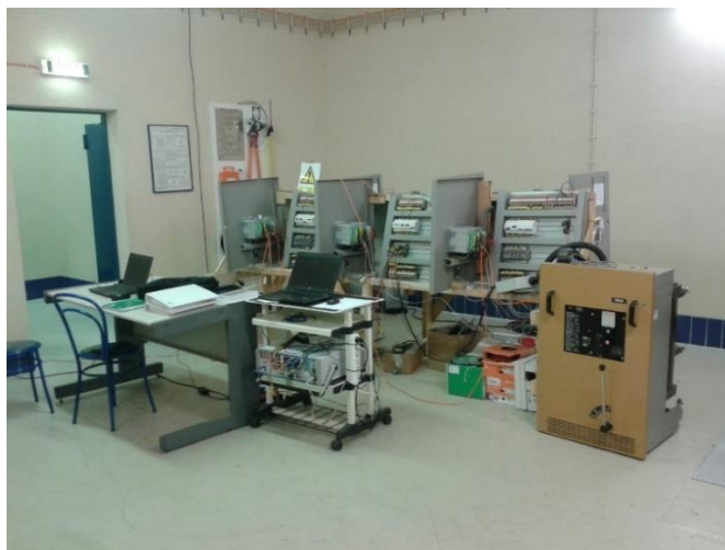
Figura 4.31 – Bancada de ensaios do painel B4 de 15 kV
