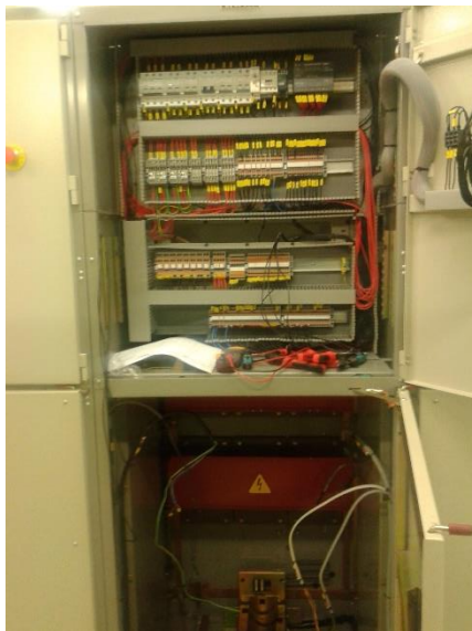
Figura 4.27 – Equipamento instalado na platina de uma cela
