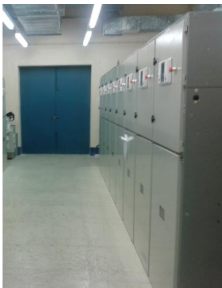
Figura 4.17 – Painel de 6 kV 91.39 02
