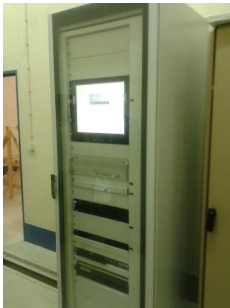
Figura 4.29 – Armário com o servidor e o SCADA instalado.
