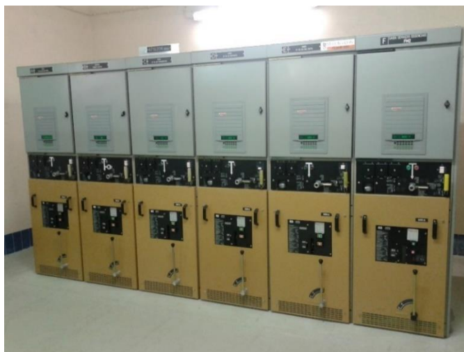
Figura 4.30 – Painel B4 de 15 kV com os relés de proteção Sepam 15
