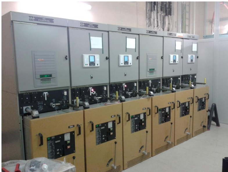
Figura 4.36 – Painéis VAMP 300F instalados nas quatro celas intervenionadas
