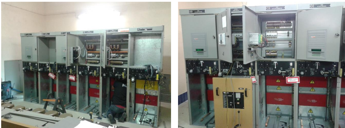
Figura 4.33 – Trabalhos de substituição dos relés de proteção nas celas B, C, E e F.
