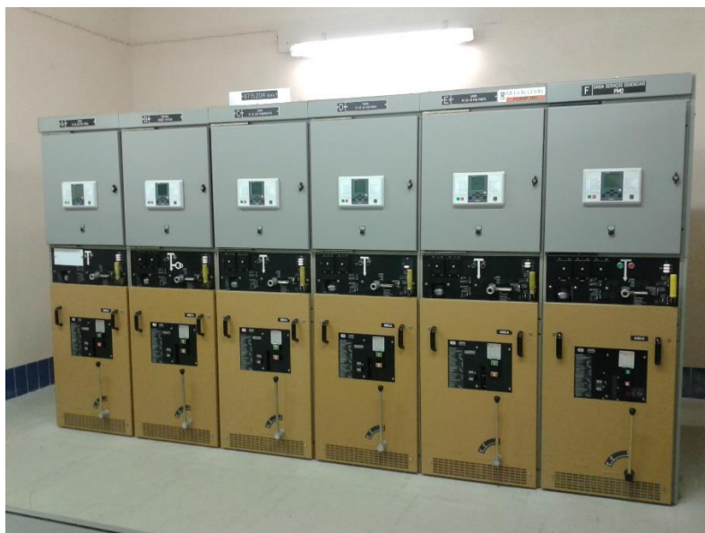
Figura 4.37 – VAMP 300F já instalados em todas as celas do painel 67.51 204
