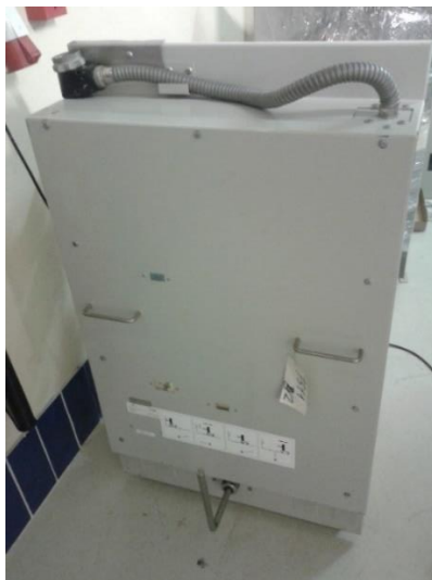
Figura 4.5 – Contactor a vácuo com tensão 7,2 kV
