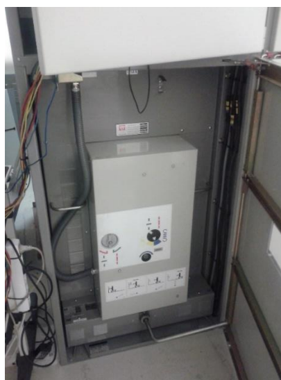
Figura 4.7 – Disjuntor SF 6 extraído na posição de teste
