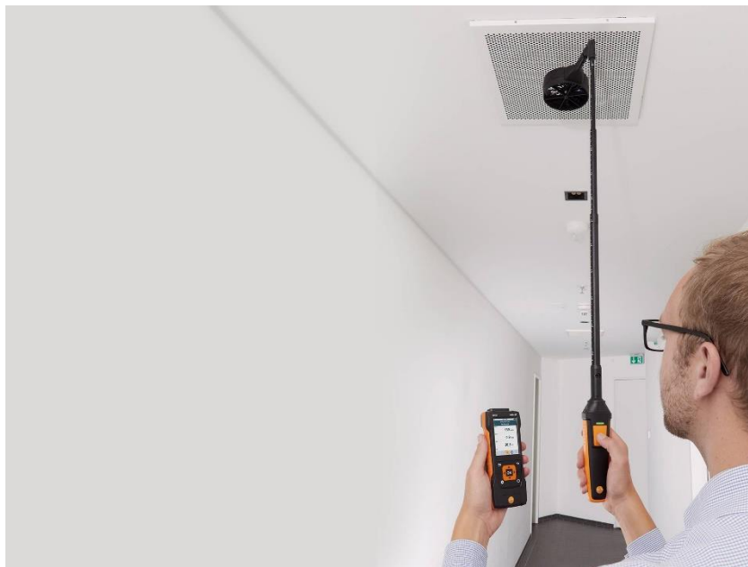
Figura 3.20 -Verificação de caudal numa unidade terminal.
