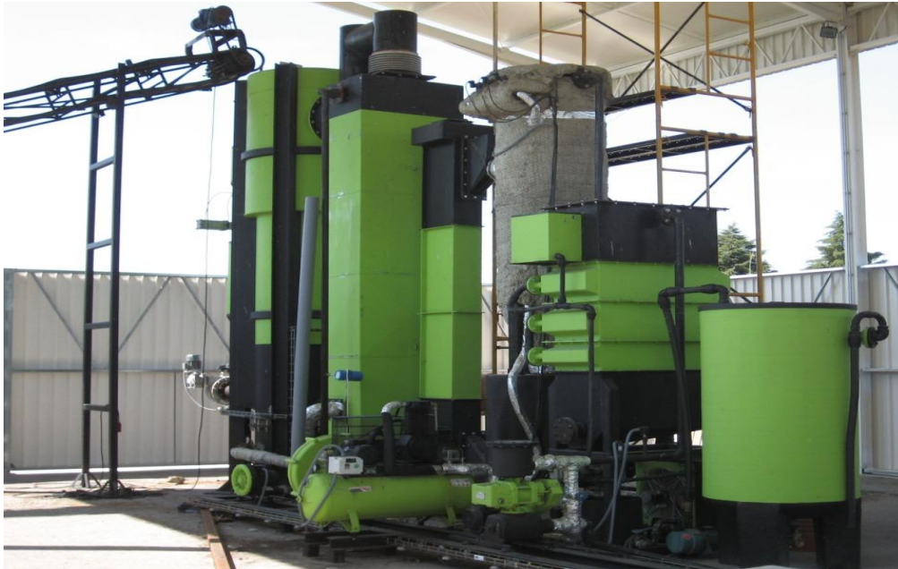
Figura 27-Central de gaseificação de biomassa da ESTG,IPPortalegre
