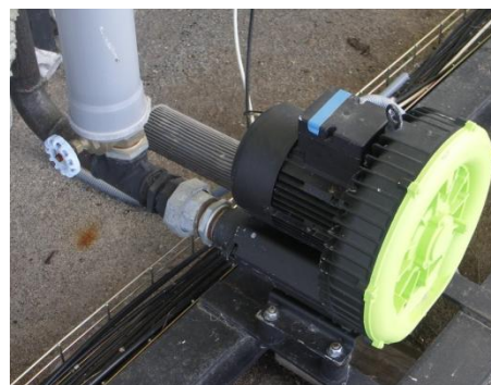
Figura 33-Bomba de injeção de ar ambiente
