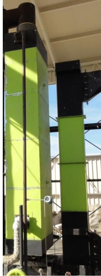
Figura 32-Permutador de calor K1 e K2
