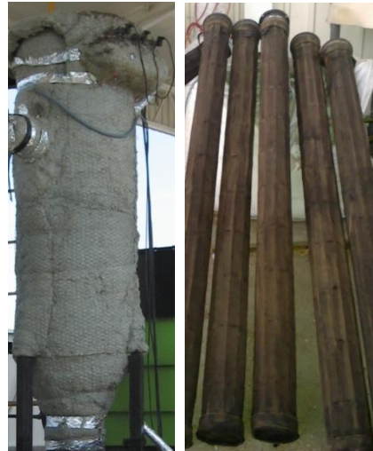
Figura 35-a) Contentor de filtros b) Filtros de mangas
