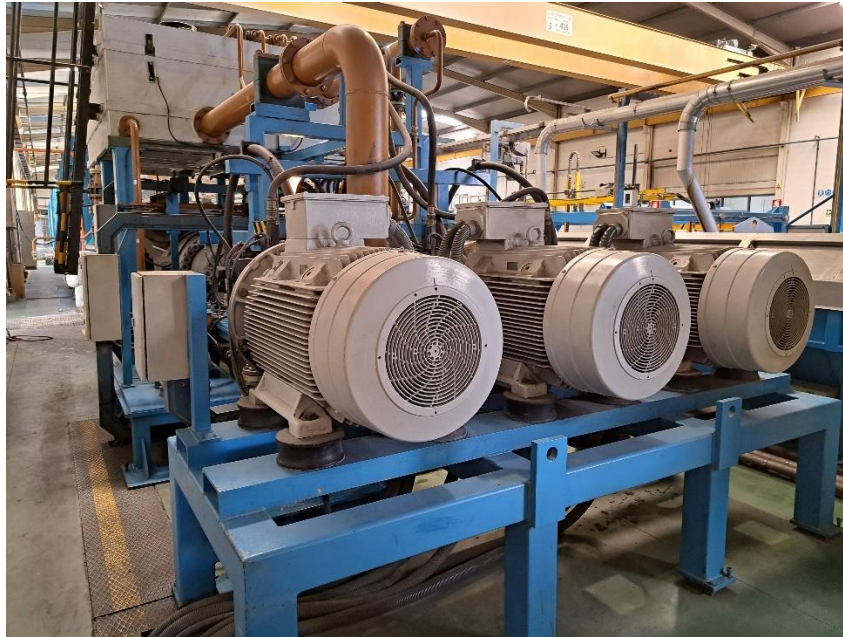
Figura 6.8: Motores das bombas hidráulicas
