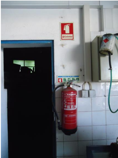
Figura 9 – Equipamentos de Segurança
