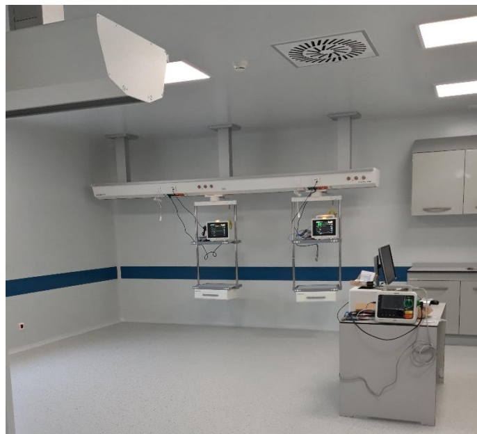
Figura 3.14 – Calhas hospitalares suspensas, marca Modul, modelo Moduflex 2500 - Instalação no BOP do IPO de Coimbra
