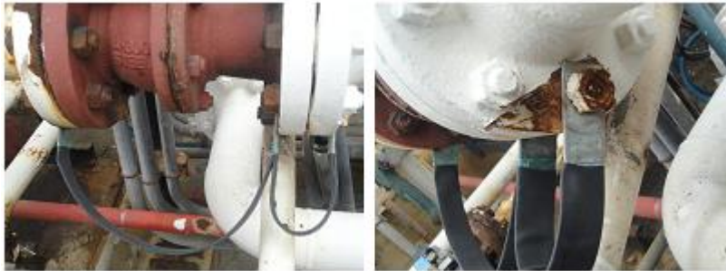
Figura 17 – Corrosão galvânica no TGLS.
