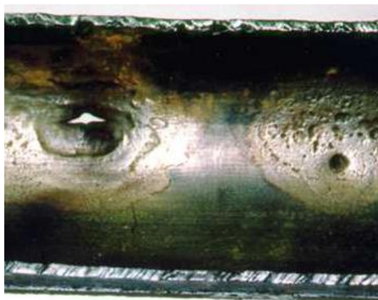
Figura 5 – Corrosão interna num tubagens [13]
