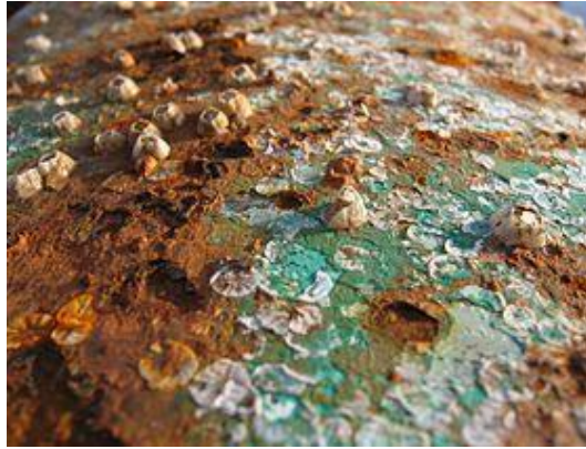
Figura 7 – Corrosão de metal pela água salgada [11].
