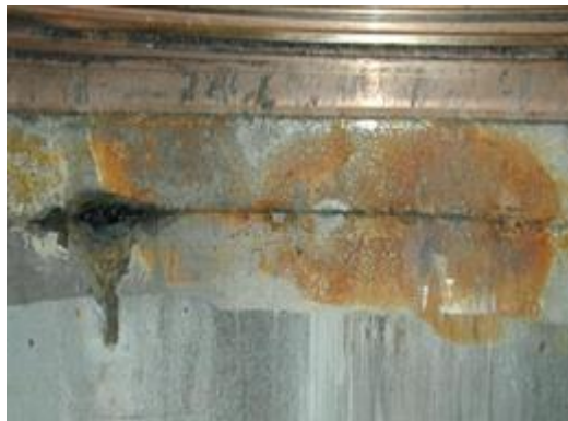
Figura 4 – Corrosão por fendas [6]
