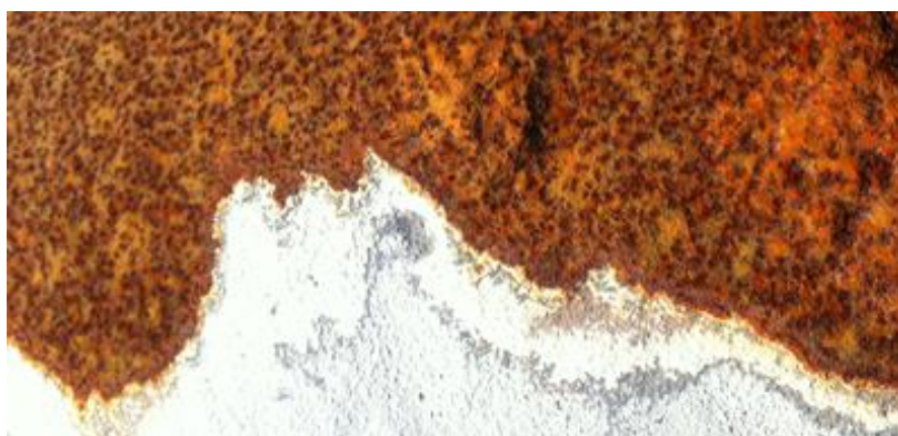
Figura 20 – Corrosão atmosférica no exterior de uma tubagem no TGLS.
