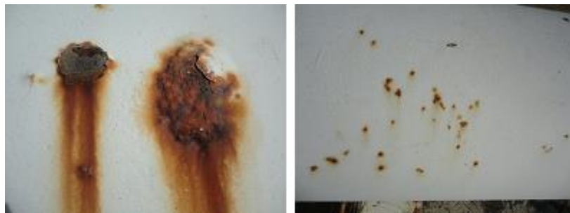
Figura 14 – Corrosão por picadas no TGLS.
