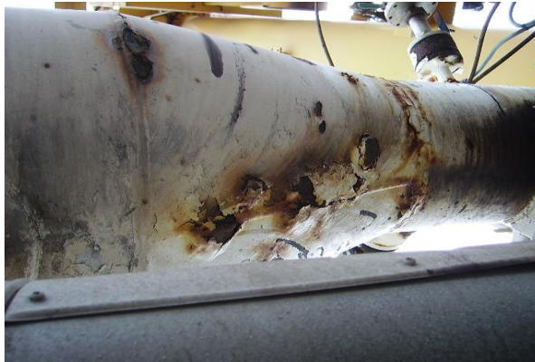
Figura 1 – Corrosão no isolamento de uma tubagem no TGLS.
