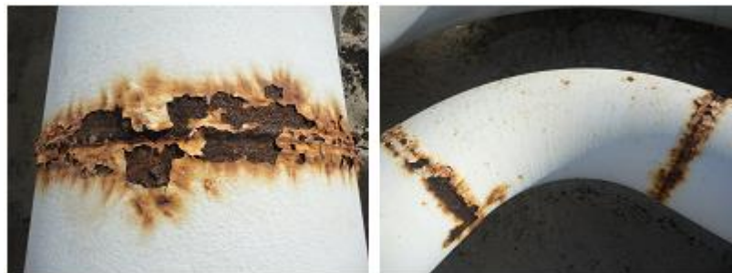
Figura 15 – Corrosão em juntas soldadas TGLS.
