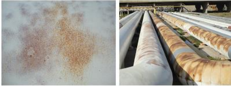
Figura 16 – Corrosão generalizada no TGLS.
