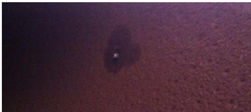
Figura 19 – Aspeto interior de um furo numa tubagem no TGLS.
