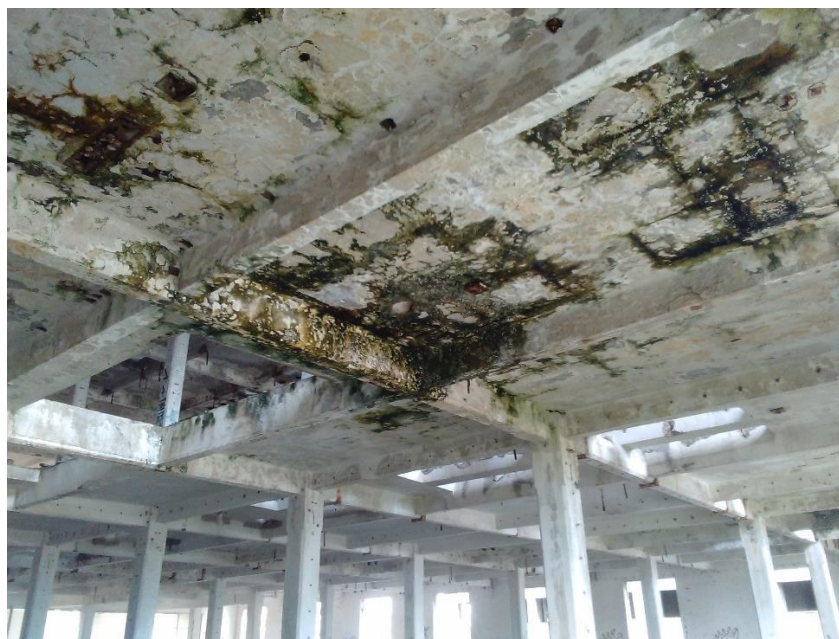
Figura 6 - Fendilhação causada por ação de agentes presentes no meio ambiente, Fábrica do Caramujo, Cova da Piedade.
