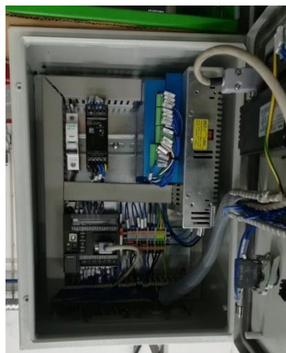
Figura 73. Quadro elétrico do divisor angular
