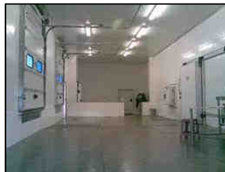
Figura 40 - Antecâmara climatizada (fonte: [7]).
