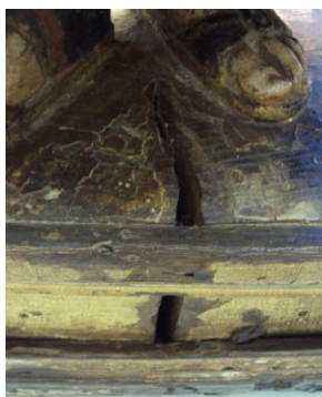
Figura 66 – Fenda na base ao longo do corte radial.
