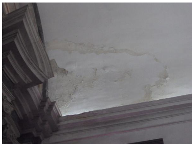
Figura 9 - Mancha provocada pela infiltração de águas, no tecto da capela-mor.
