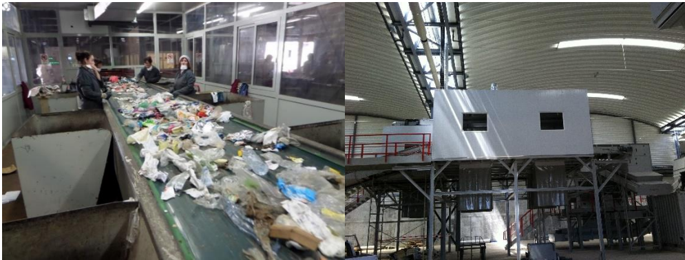
Figura 25- Cabines de Triagem. [Fonte: Cedido pela Resitejo]
