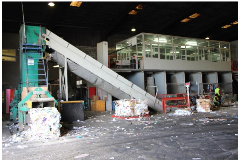
Figura 6- Enfardadeira e cabine de triagem na Estação de Triagem. [Fonte: Cedida pela Resitejo]
