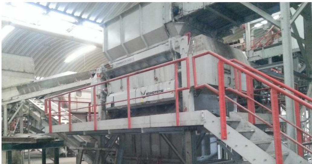
Figura 26- Triturador Primário. [Fonte: Elaboração própria]
