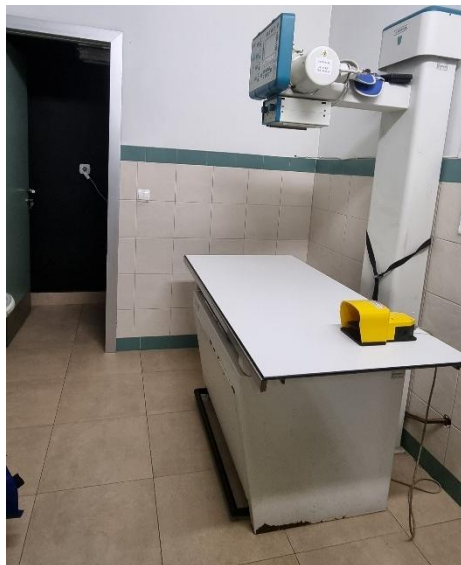
FIGURA 12. SALA DE RADIOLOGIA. (FONTE: INSTITUIÇÃO DE ACOLHIMENTO)
