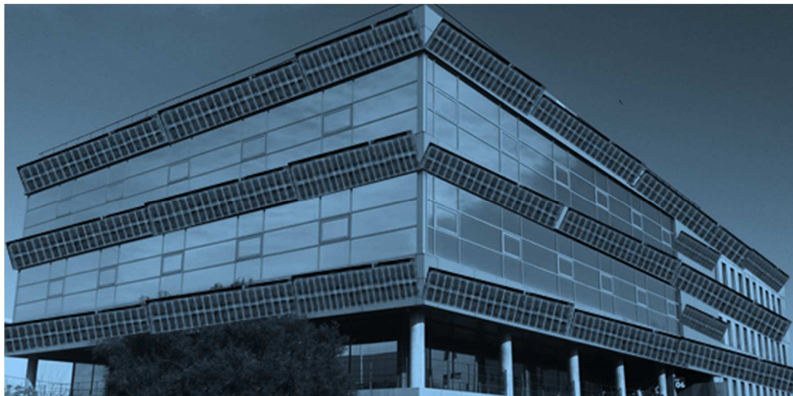
Figura 4.7 – Exemplificação da instalação dos painéis fotovoltaicos na fachada sudeste e sudoeste do edifício
