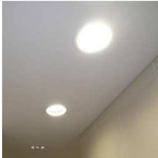
Figura 3.8 – Luminárias das Instalações Sanitárias
