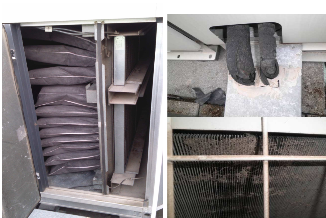
Figura 3.32 – Estado de alguns equipamentos de AVAC
