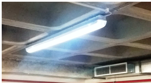
Figura 3.7 – Luminárias dos estacionamentos
