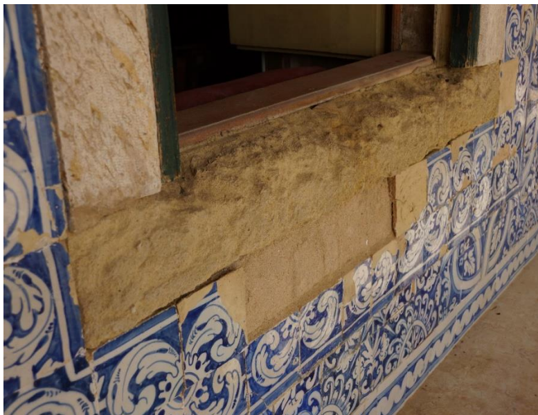
Figura 10: parapeito de uma das janelas do pátio grande com sinais evidentes de perda de coesão.
