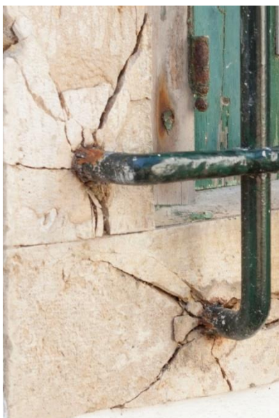
Figura 4: fendilhação da pedra provocada pela oxidação do ferro (pátio grande).
