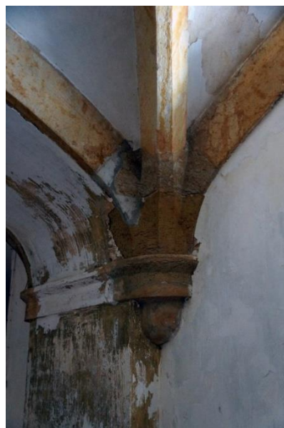
Figura 5: preenchimentos, marcas de infiltração e colonização por fungos (adega dos Frades).
