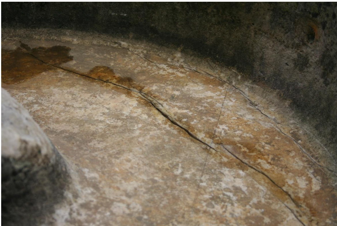
Figura 55: extensão das fendas existentes na base do bojo.
