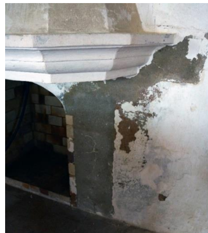
Figura 9: preenchimento com cimento Portland no revestimento da parede sudoeste da adega dos Frades.
