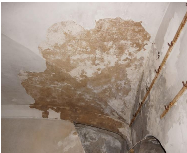
Figura 6: presença de sais solúveis nos revestimentos da cozinha (parede sudoeste).
