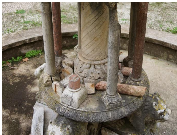
Figura 14: vários elementos estruturais fraturados.
