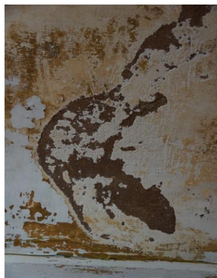
Figura 7: presença de sais solúveis nos revestimentos da adega dos Frades (parede sudoeste).
