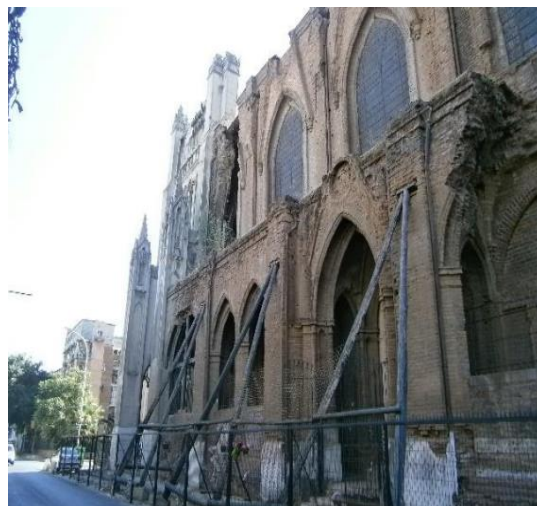
Figura 11-Estrutura de contenção de emergência [13]
