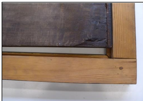
Fig. 128. Folga entre a moldura e a pintura. A.P.
