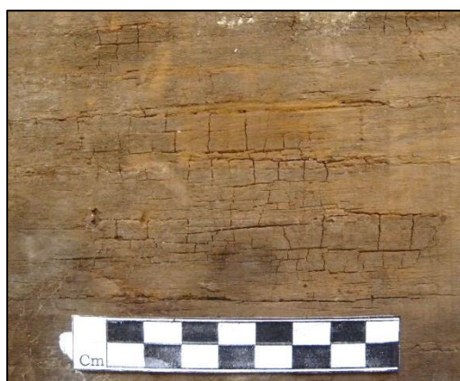
Fig. 78. Pormenor da podridão castanha com fendas paralelas e perpendiculares (cubos). A.P.
