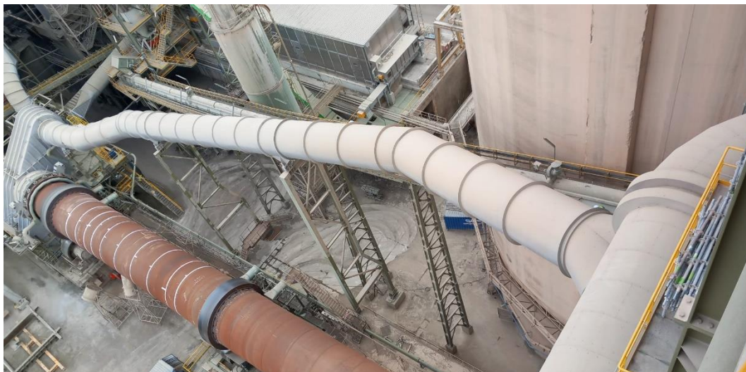
Figura 3.8 - Conduita de ar terciário instalada na Secil no âmbito do Projeto CCL - Clean Cement Line .
