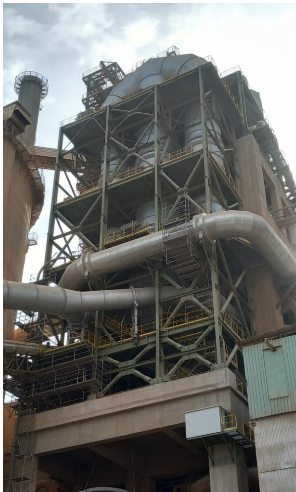
Figura 3.4 - Calcinador instalado na Secil no âmbito do Projeto CCL - Clean Cement Line .
