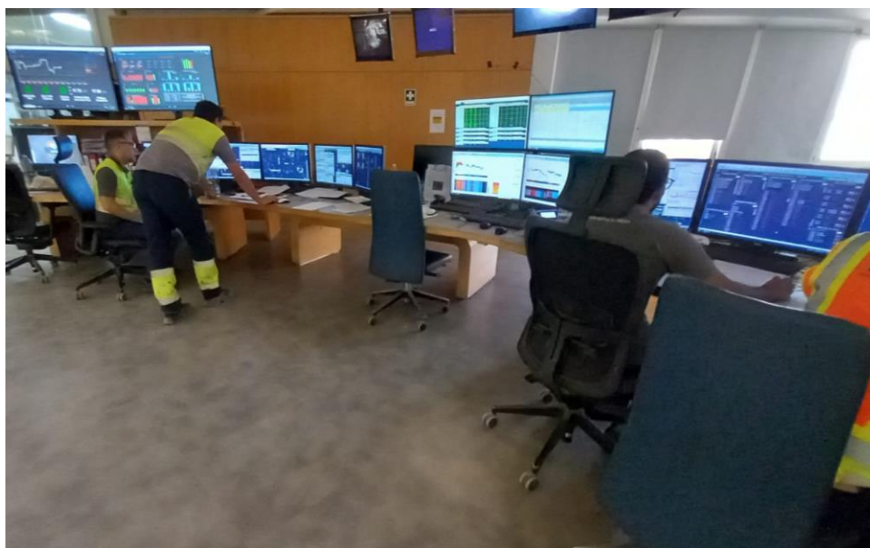
Figura 4.7 - Sala de comando centralizado da Secil.
