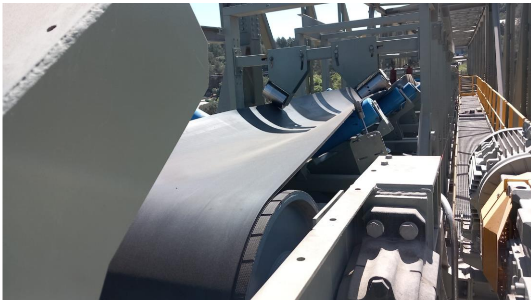
Figura 4.23 – Troço de transferência de material de CDRs à zona de secagem. Ponto de leitura válido devido à facilidade de instalação do sensor na estrutura.
