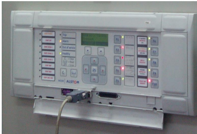
Figura 6.6 – Proteção Micom P545 da Alstom.
