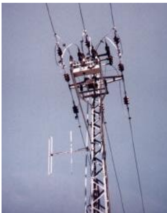
Figura 3.10 - Interruptor Aéreo Telecomandado em apoio MT.
