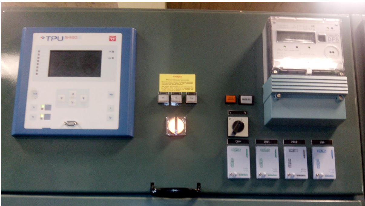
Figura 6.4 – Painel Linha MT com Proteção EFACEC TPU S420.
