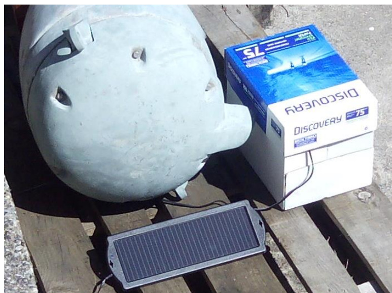
Figura 4.16 – Sistema de monitorização de qualidade de sinal com painel solar fotovoltaico.
