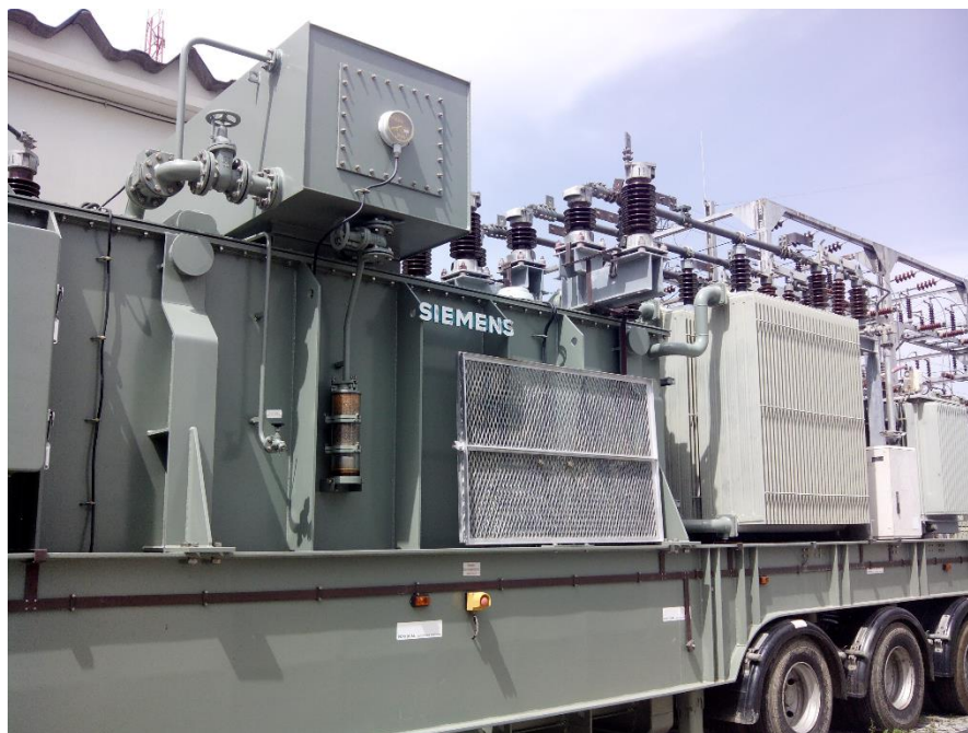
Figura 6.2 - Transformador de Potência móvel da marca Siemens.
