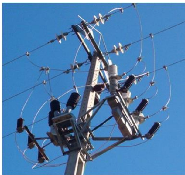
Figura 3.9 – Interruptor Auto-Religador em apoio MT.
