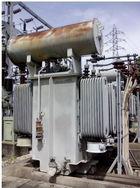
Figura 6.1 – TP1 da Subestação da Lousã.
