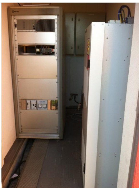
Figura 97. Site de equipamentos com bastidor de RSC e bastidor de GSM-R
