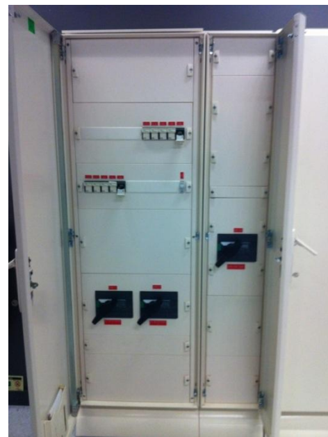
Figura 55. CORE – Quadro elétrico
