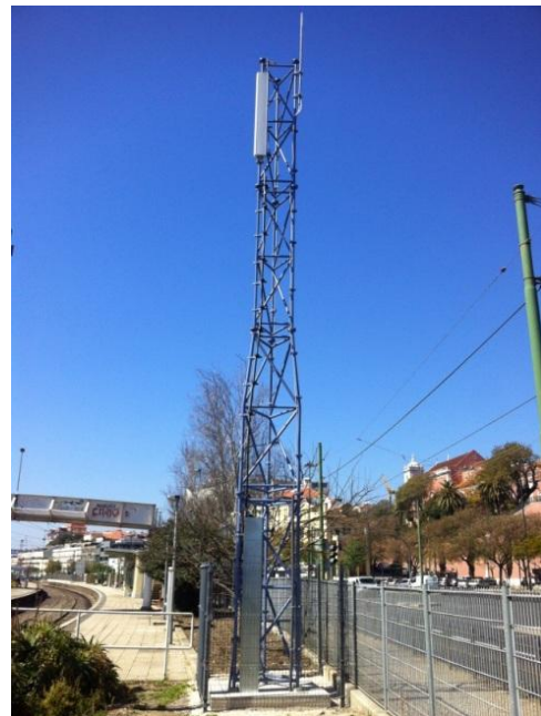
Figura 77. Conjunto repetidor e antenas
