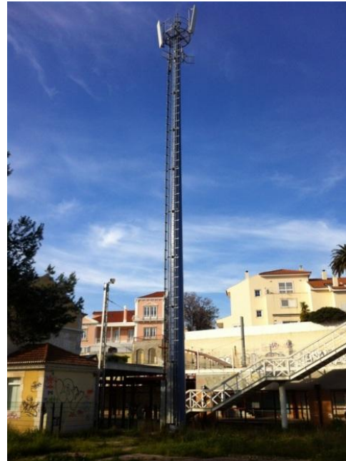
Figura 74. BSS –Torre de antenas
