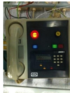
(d) Equipamentos comunicações de estação
