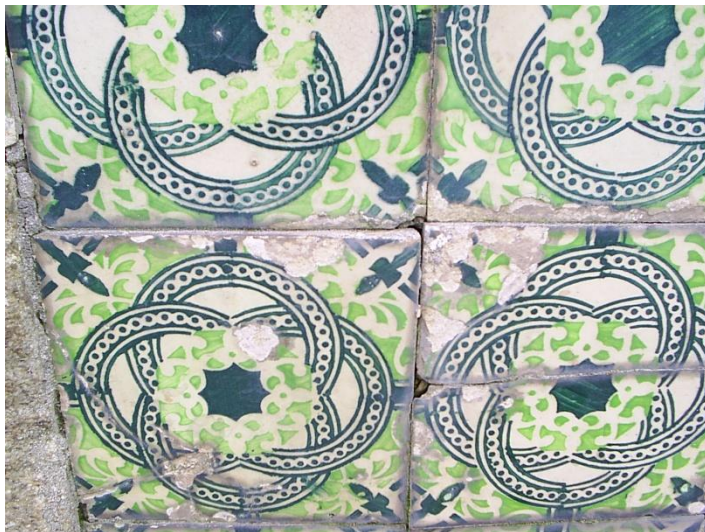
Concreções e fractura
