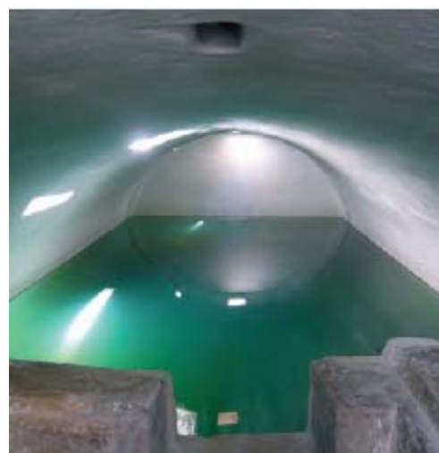
Figura 79. Cisterna Cisterna Depois
