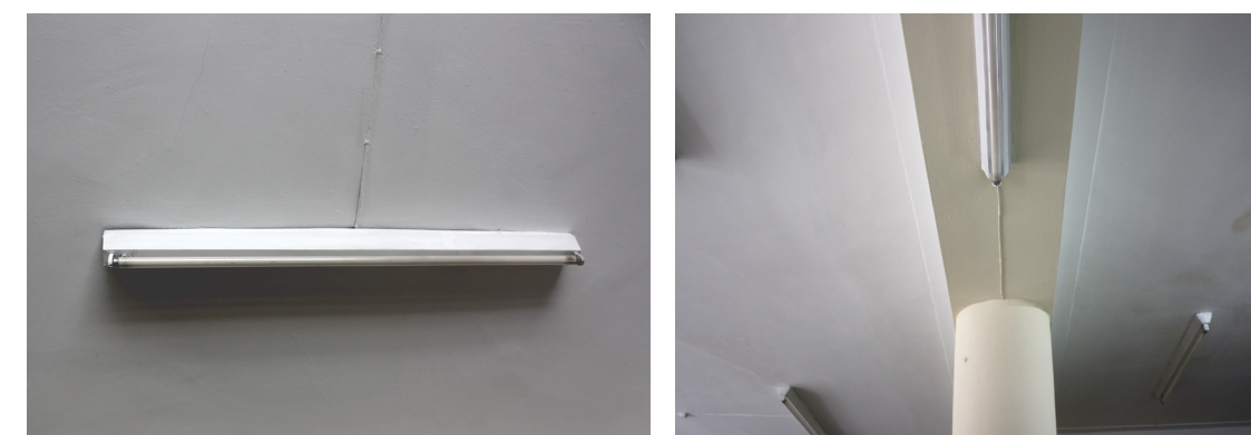
Imagens 171/172 – Lâmpadas tubulares fluorescentes
