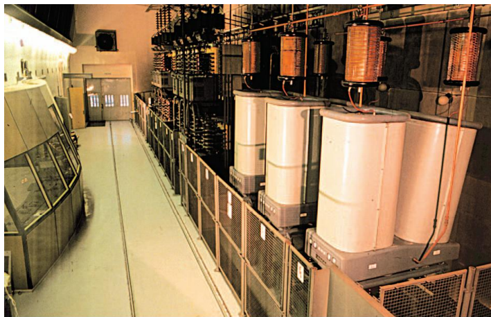
Figura 2.29 – Estação conversora de Gotland com conversores de válvulas de arco de mercúrio e de tirístores (extraído de [12]).
