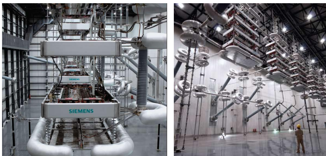
Figura 2.35 – À esquerda, torre de módulos de tiristores de um sistema HVDC de 800kV. À direita, sala eléctrica desse sistema (extraído de [41]).
