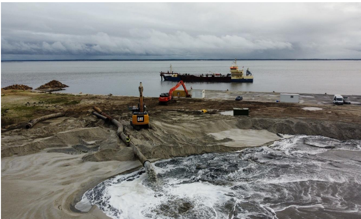
Figura 17 – Polpa água/sedimentos a serem descarregados no terrapleno para constituir a pilha de areia
